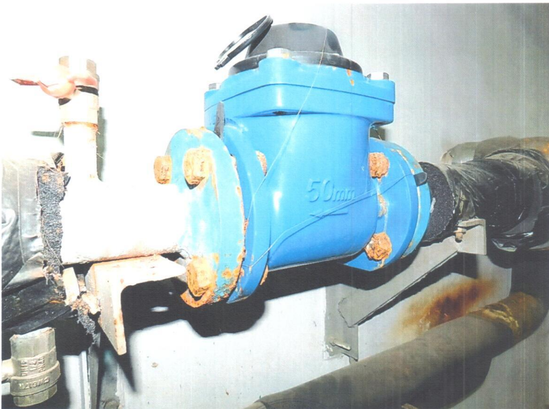
Фотоиллюстрация 14. Коррозия арматуры и фланцевых соединений на трубопроводах ХВС
