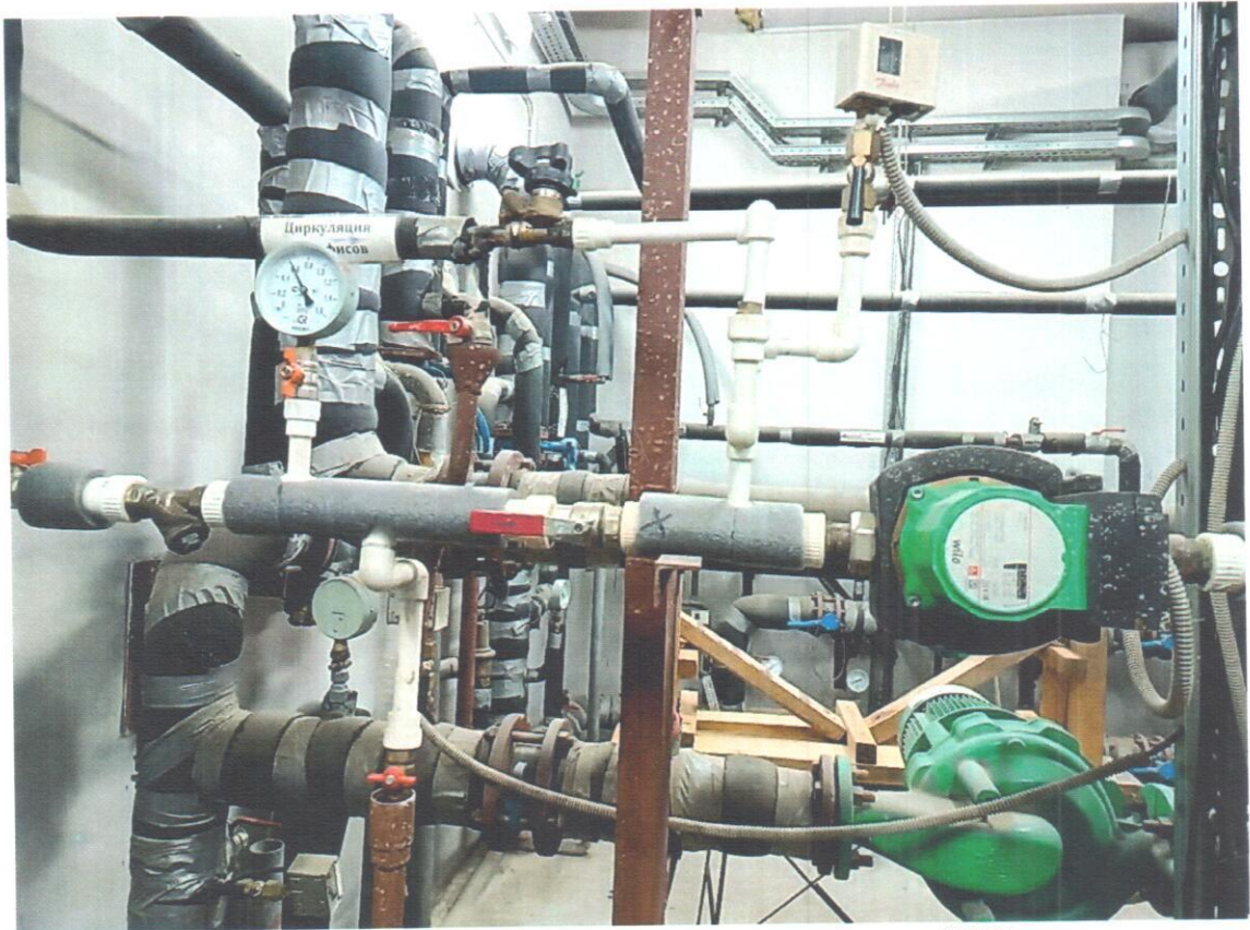
Фотоиллюстрация 3. Индивидуальный тепловой пункт (ИТП)
