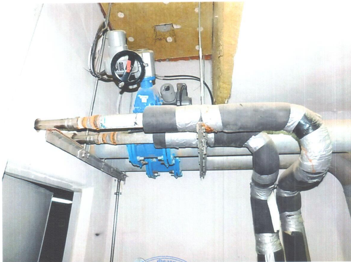
Фотоиллюстрация 18. Прокорродировавшие трубопроводы ХВС
