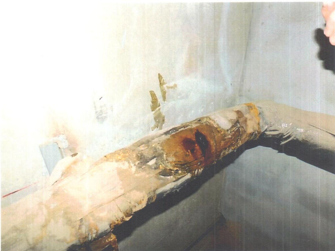
Фотоиллюстрация 13. Прокорродировавшие трубопроводы от повысительной насосной станции ХВС
