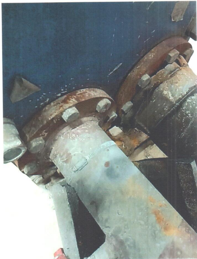
Фотоиллюстрация 7. Прокорродировавшая трубная обвязка теплообменного аппарата ГВС в ИТП
