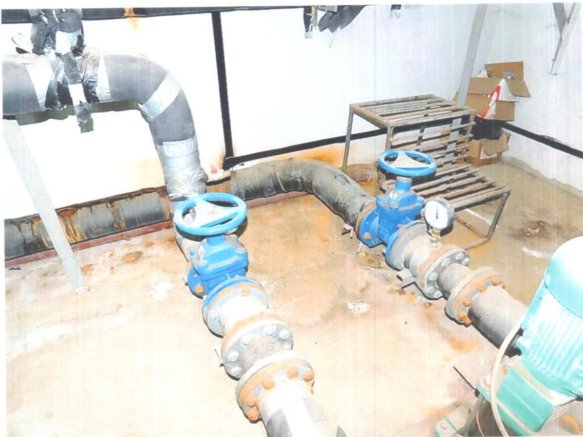
Фотоиллюстрация 17. Прокорродировавшая трубная обвязка повысительной насосной станции ХВС
