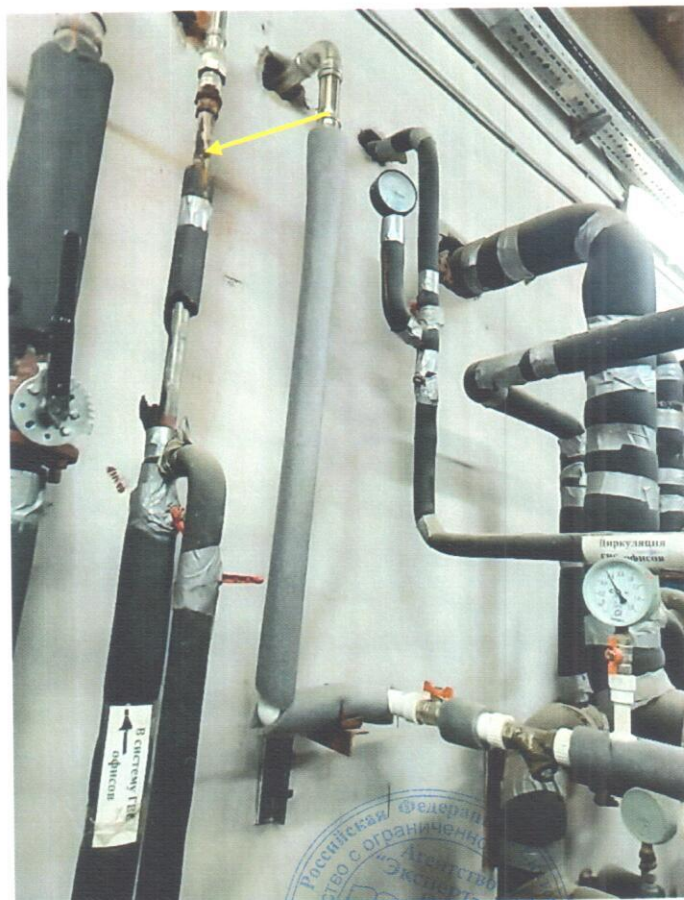
Фотоиллюстрация 4. Прокорродировавшие элементы трубопроводной системы ГВС в ИТП
