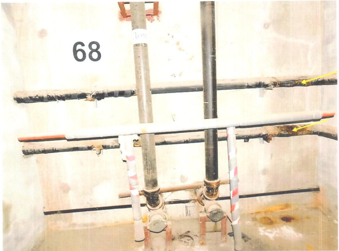
Фотоиллюстрация 11. Прокорродировавшие трубопроводы ХВС подачи воды в ИТП
