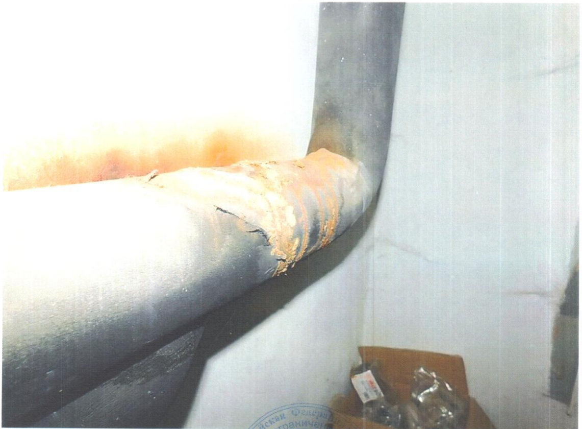
Фотоиллюстрация 16. Коррозия трубопроводов ХВС
