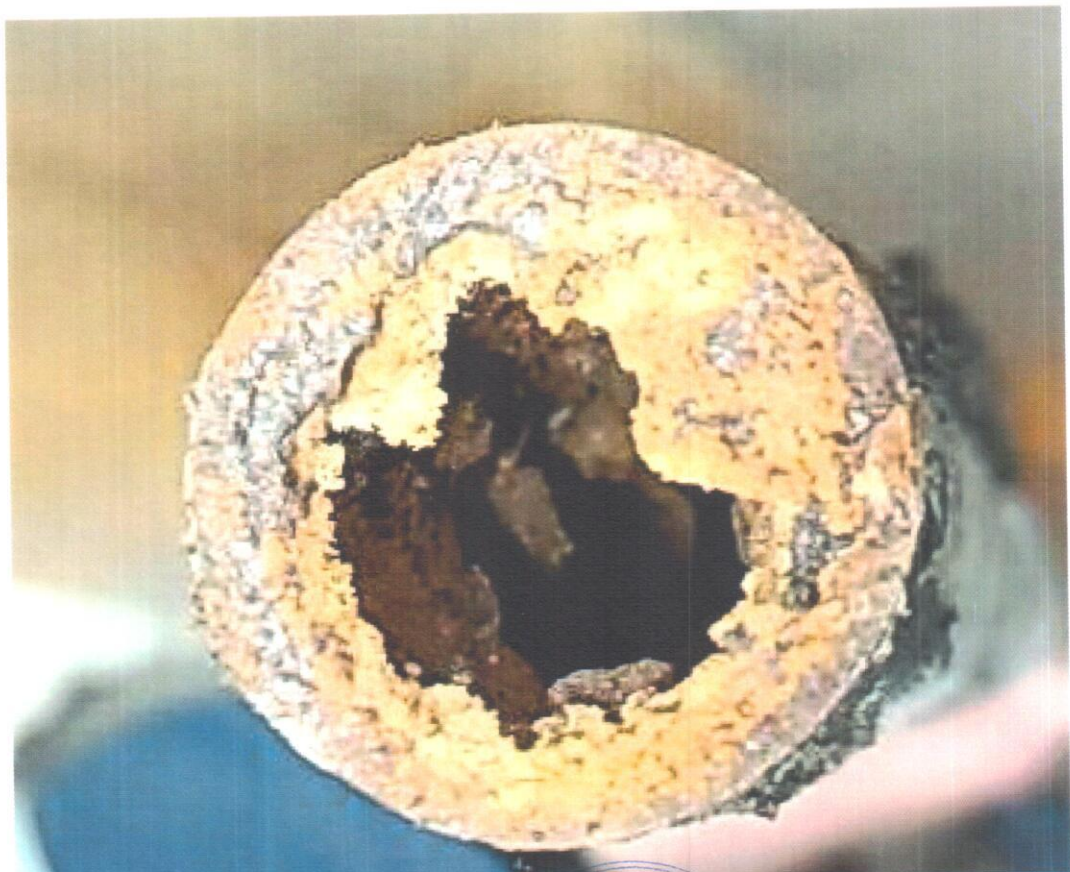
Фотоиллюстрация 6. ИТП. Продукты коррозии внутри магистрального трубопровода ГВС. Бугристые продукты коррозии внутри трубопроводов
