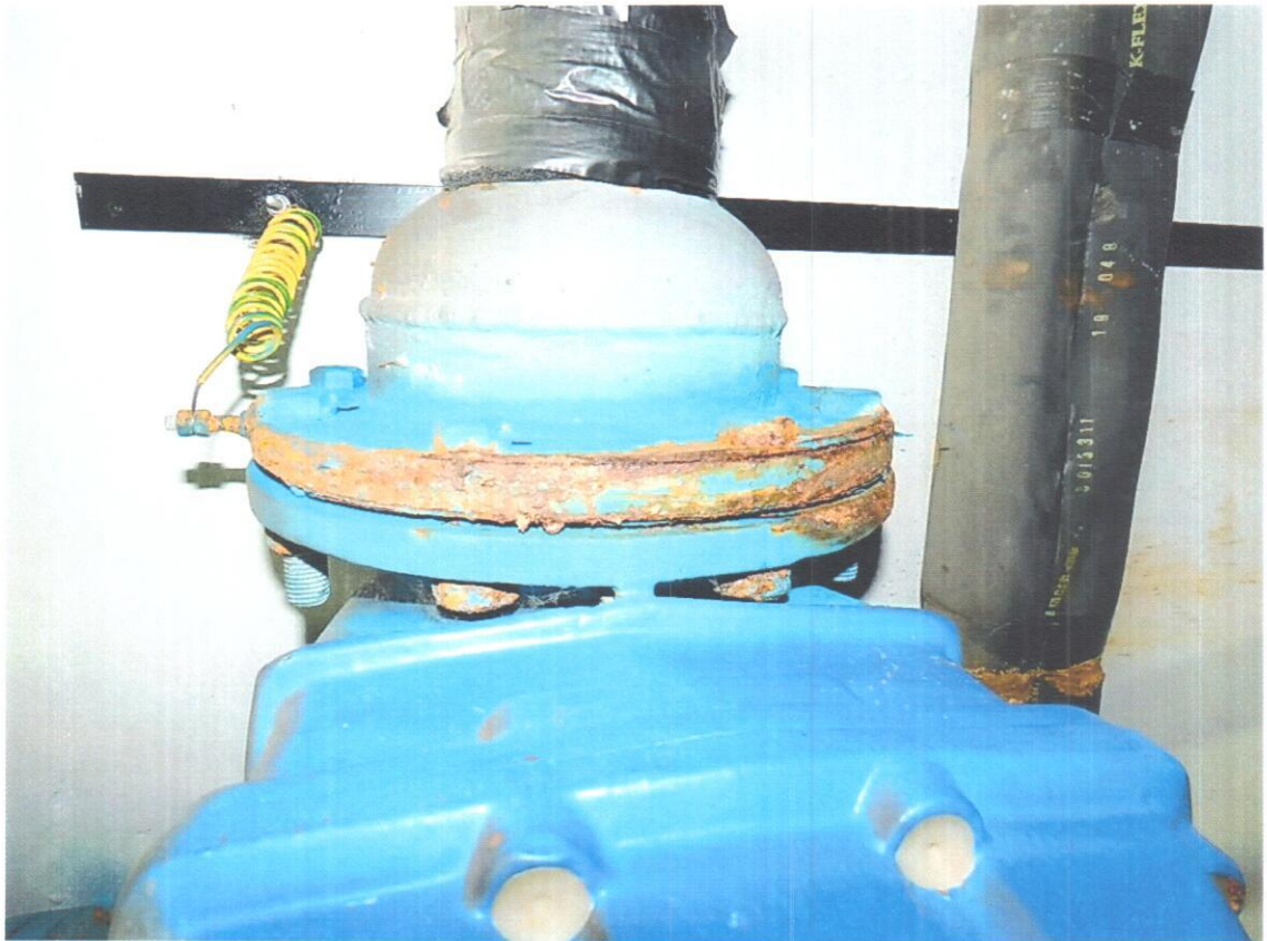
Фотоиллюстрация 15. Коррозия арматуры и фланцевых соединений на трубопроводах ХВС
