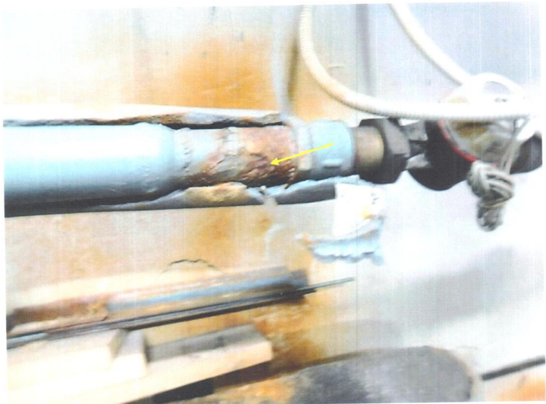
Фотоиллюстрация 5. Прокорродировавшие элементы трубопроводной системы ГВС в ИТП
